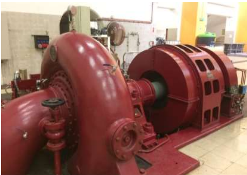
Figura 3. Gerador auxiliar na Central Hidroelétrica de Castelo do Bode (Fonte: Autores, 2019, com autorização da Central Hidroelétrica de Castelo do Bode).
