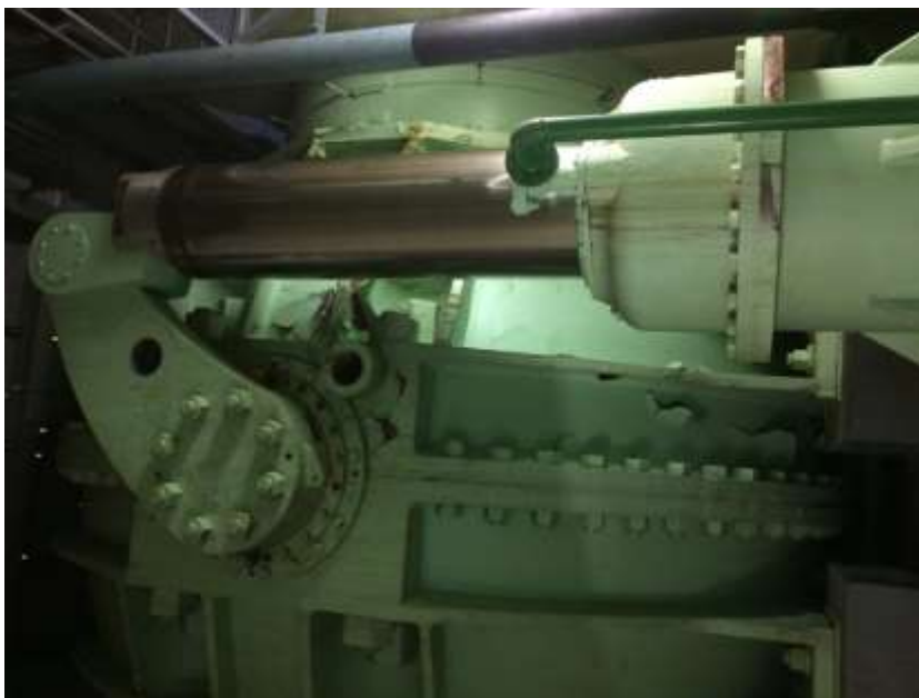
Figura 4. Turbina na Central Hidroelétrica de Castelo do Bode (Fonte: Autores, 2019, com autorização da Central Hidroelétrica de Castelo do Bode).
