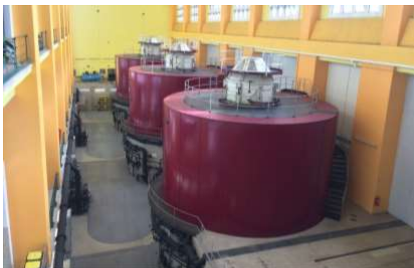
Figura 2. Três grupos de geradores principais com turbinas tipo Francis da Central Hidroelétrica de Castelo do Bode (Fonte: Autores, 2019, com autorização da Central Hidroelétrica de Castelo do Bode).
