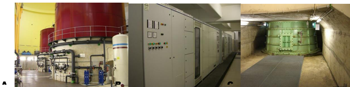
Figura 3. Equipamento da Central Hidroelétrica de Castelo do Bode. A- Diversas tubagens de refrigeração a água; B- Aparelhos de controlo e segurança dos grupos geradores; C- Difusor, onde ocorre a saída de água da roda de uma turbina.
